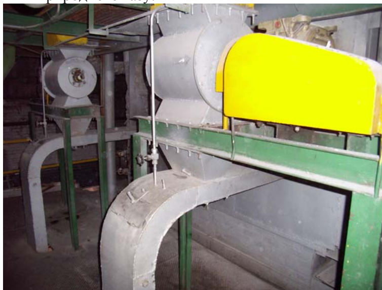
Фото 3. Короба постачання повітря у топку котла КЕ-18-22-330ГДВ та живильники
