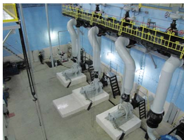
Фото 6. Насосне обладнання КНС № 2А.
