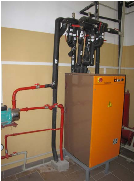
Фото 7. Теплонасосна установка «Ciat» ТВВ-65
