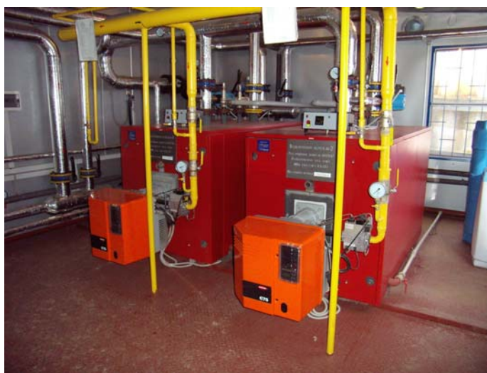
Фото 9. Нова котельня Безлюдівського проммайdanчика
