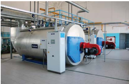
Современная котельная ВЧД г. Купянск
