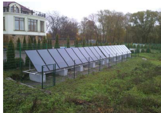
Солнечные батареи, г. Миргород
