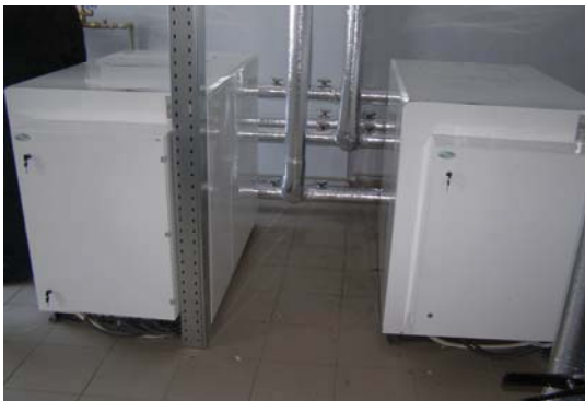
Тепловые насосы в БМЕУ, г. Харьков
