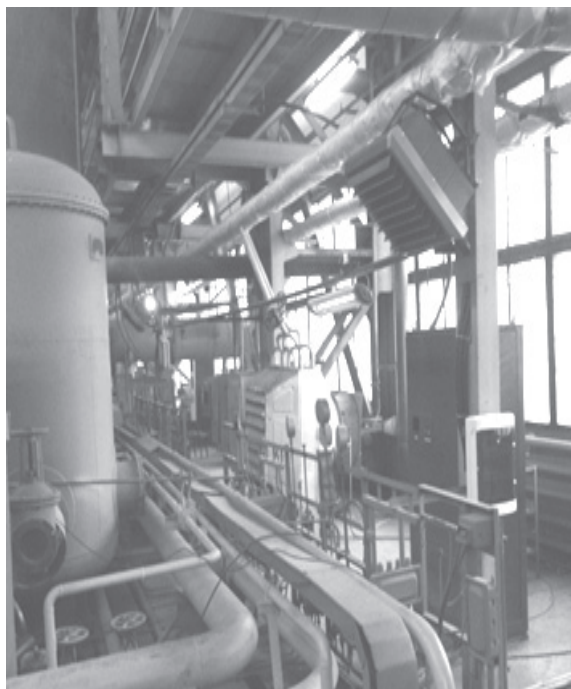
Рис. 3. Использование ламп УФО (UFO Line) для местного нагрева измерительной системы испытательной станции.
