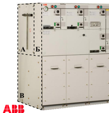
Рис. 6. КРУЭ SafeRing: А – аппаратный отсек, Б – отсек управления, В – кабельный отсек
