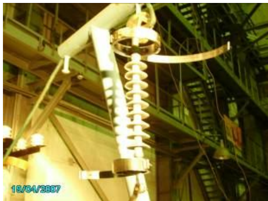
Рис. 5 – Индикаторы пробоя зафиксировали протекание тока короткого замыкания вдоль макета изолятора – концы сигнальных лент освободились из замков
