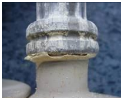
Рис. 1 – Нарушение герметизации силового узла линейного полимерного изолятора типа ЛК
