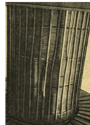
Рис. 2 – Деформированная обмотка трансформатора из-за воздействия токов короткого замыкания
