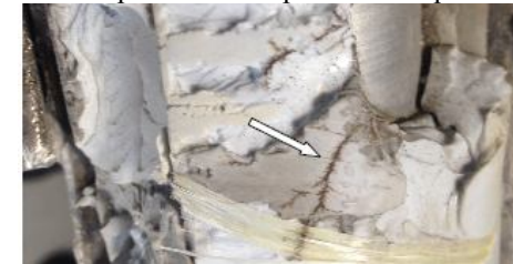
Рис. 1 – Следы электрических разрядов
