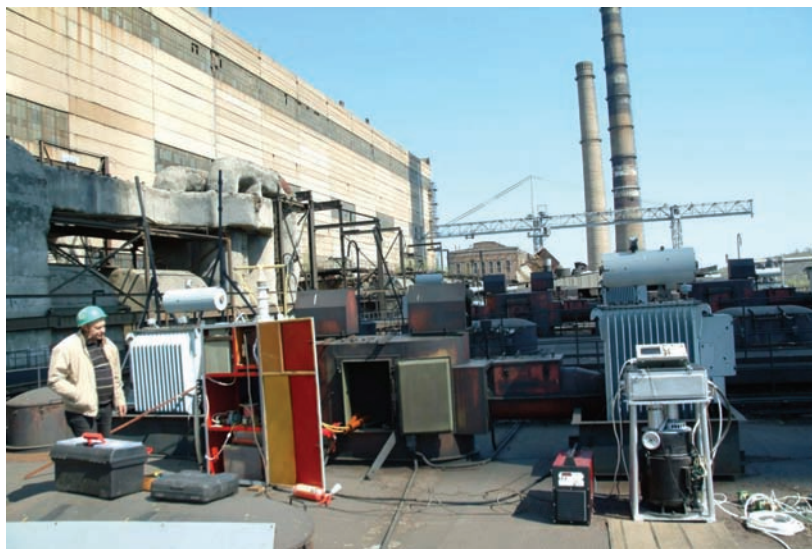
Рисунок 2 – Общий вид экспериментального импульсного оборудования во время натурного эксперимента на ТЭС
