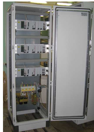
Рисунок 4 – Внешний вид шкафа управления фазами
