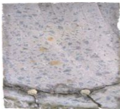
Рис. 4 – Характер разрушения железобетонных конструкций при изгибе
