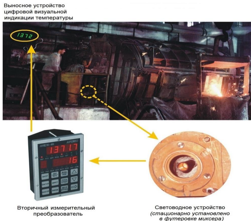
Рис. 2. Непрерывный световодный термоконтроль жидкого чугуна в индукционном канальном миксере.
